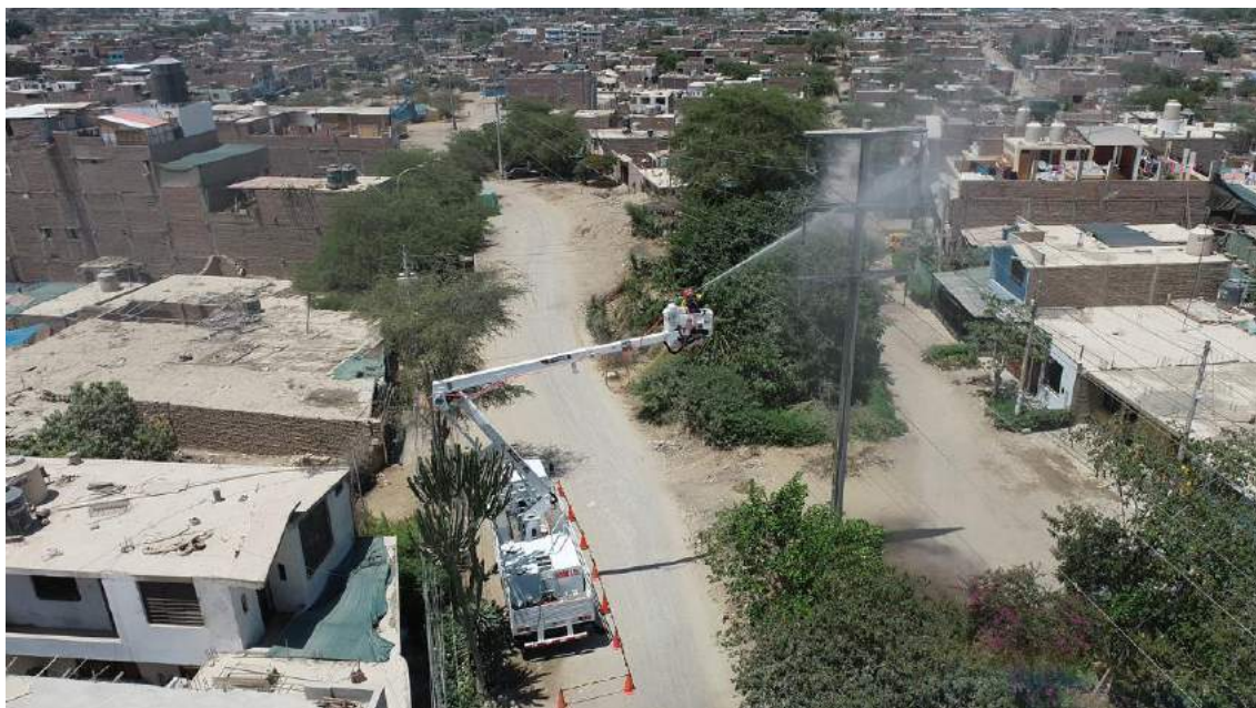
Lavado en línea de AT
